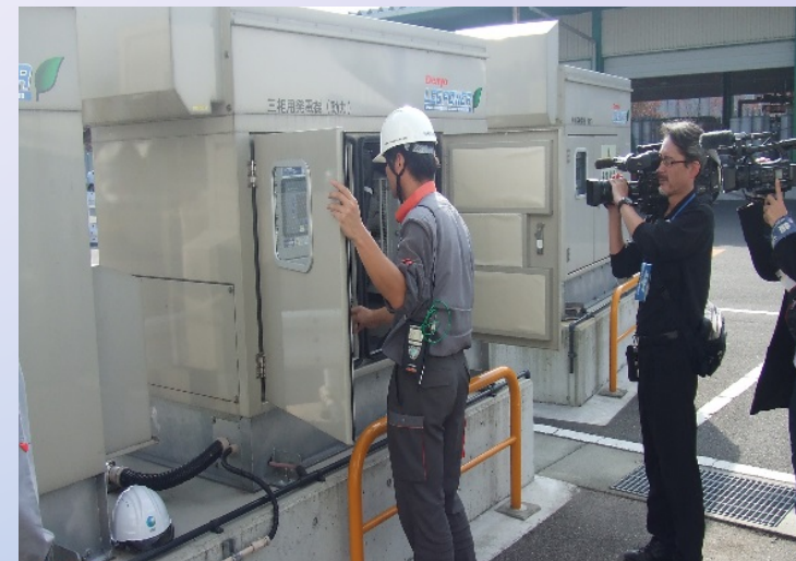
LPガス発電機の作動
