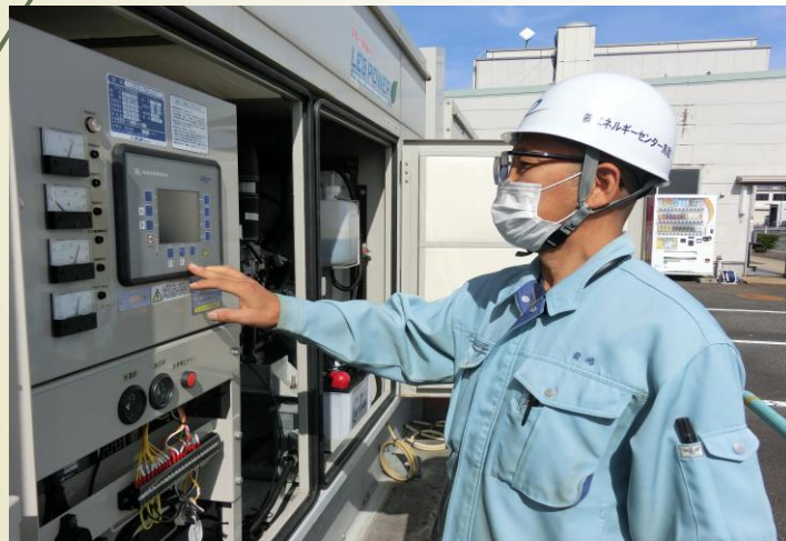
非常用発電機稼働
